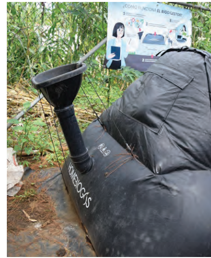
Uno de los dos biodigestores que alimentan la cocina de gas y producen biol.
